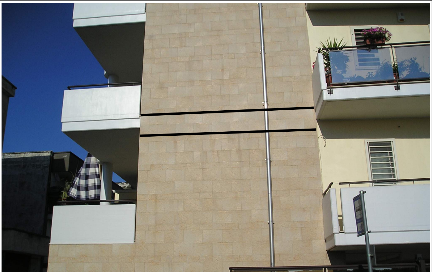
Fig. 1: Parete di tamponamento Ovest dopo il ripristino del rivestimento (fascia compresa tra le due linee nere).
